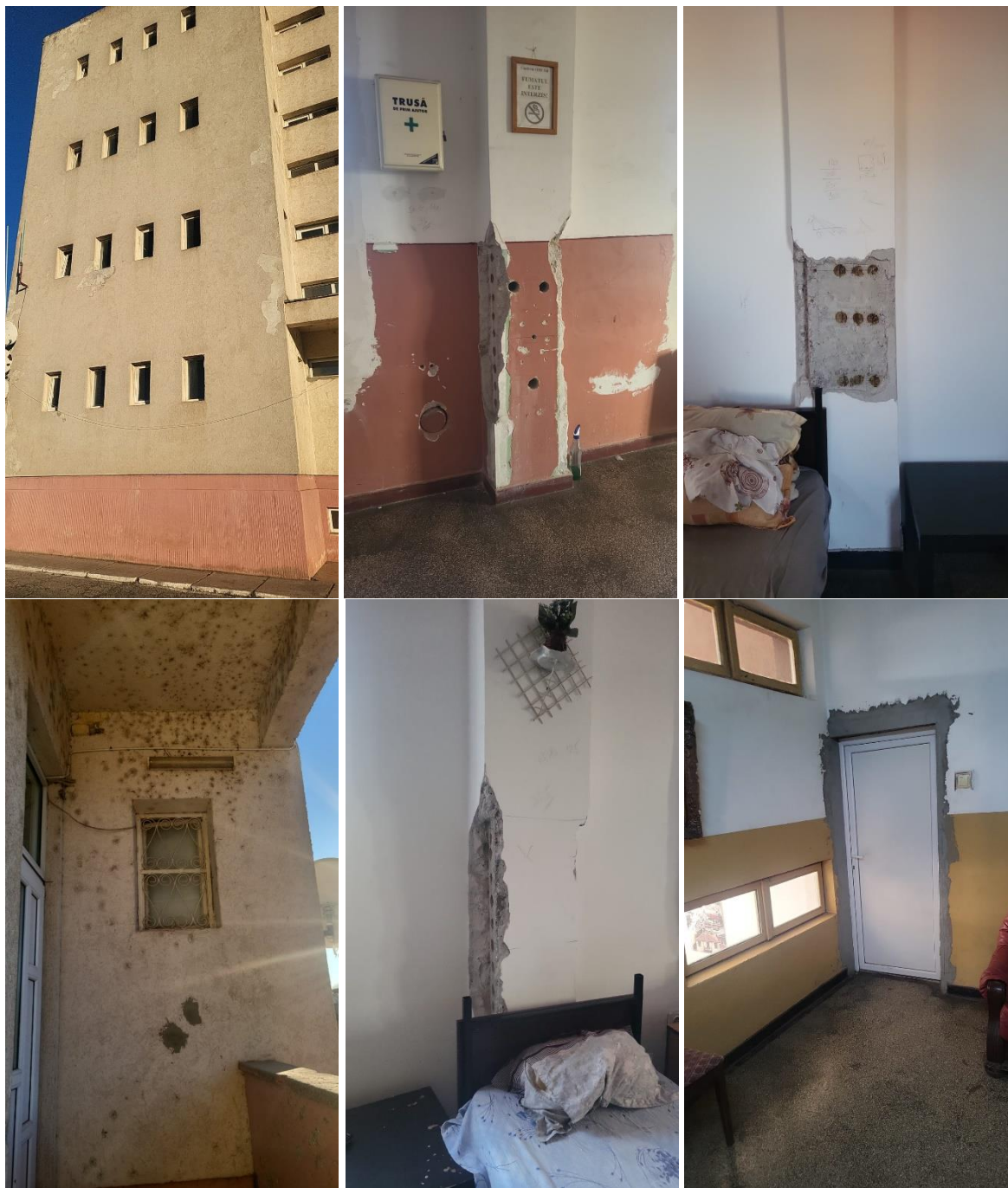
Figura 6 Imagini care reflectă starea precară a clădirii actuale a DPC-P
